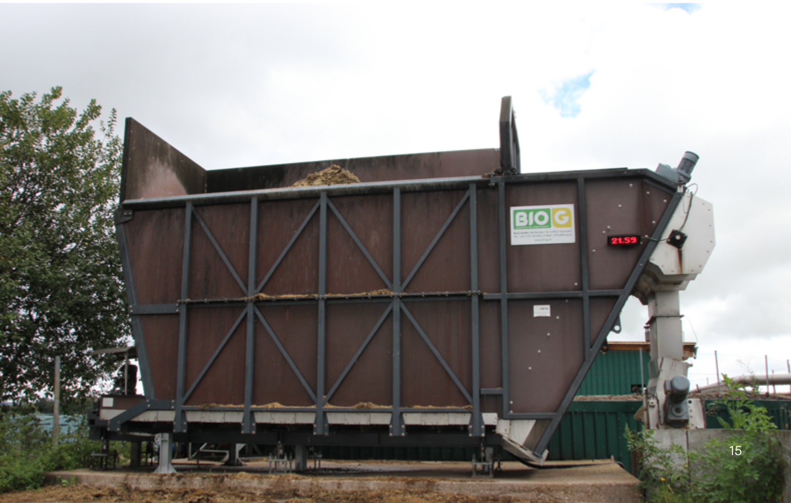
Abbildung 10: Ein BioFeeder der Firma BioG um das faserreiche Material zu verarbeiten
