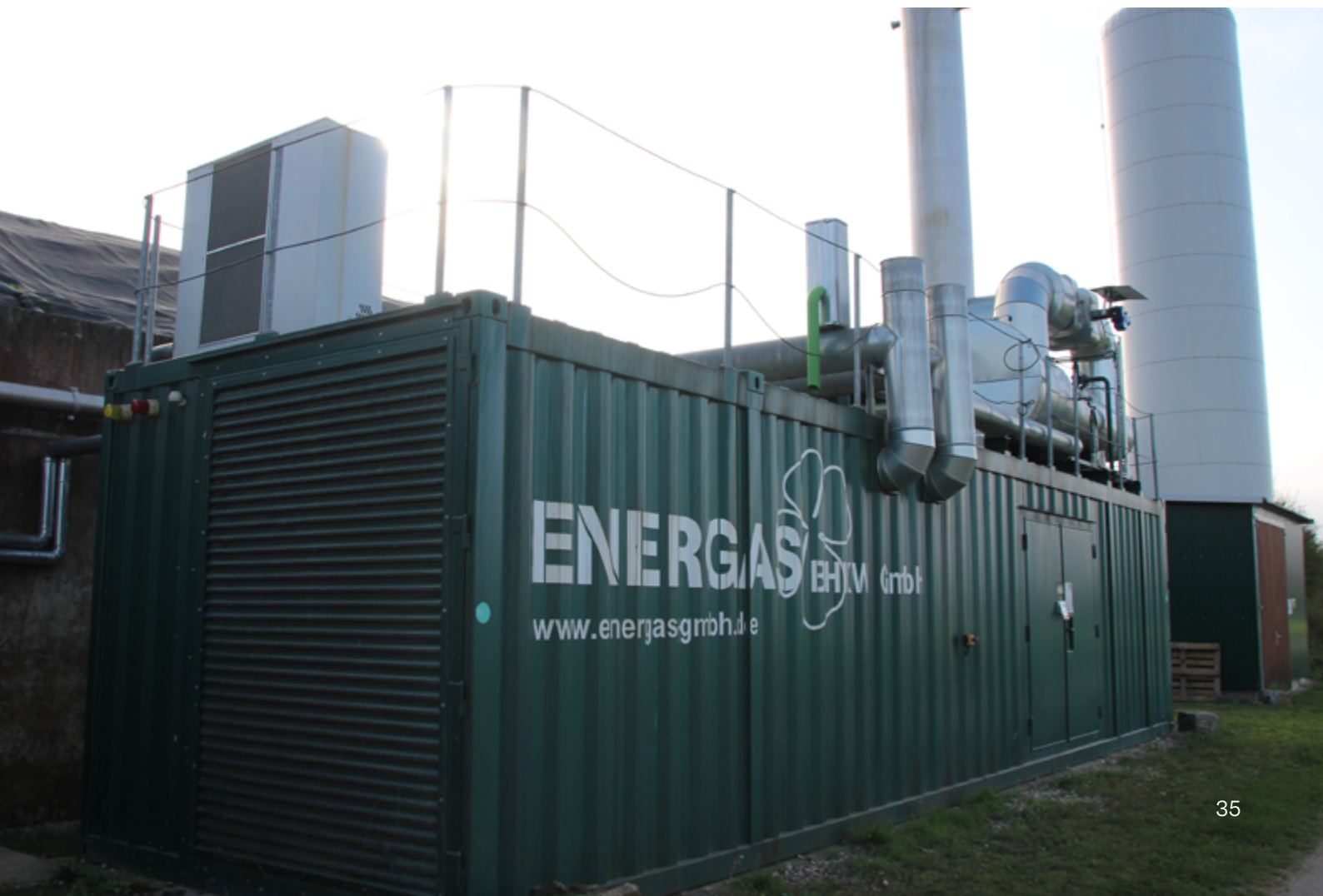
Abbildung 20: Das BHKW mit 900 kW als ContainerKomplettlösung der Firma Energias
