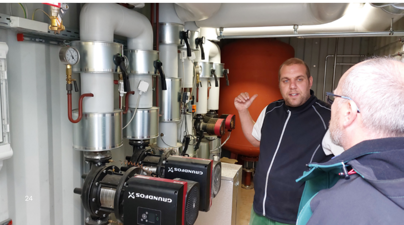
Abbildung 14: Betreiber Stefan Mühlbach demonstriert die Steuerungstechnik für seine Abwärme
